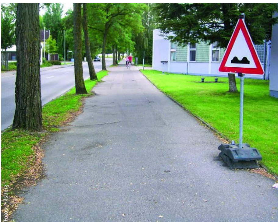
Vor Wurzelschäden an öffentlichen Straßen muss gewarnt werden.
